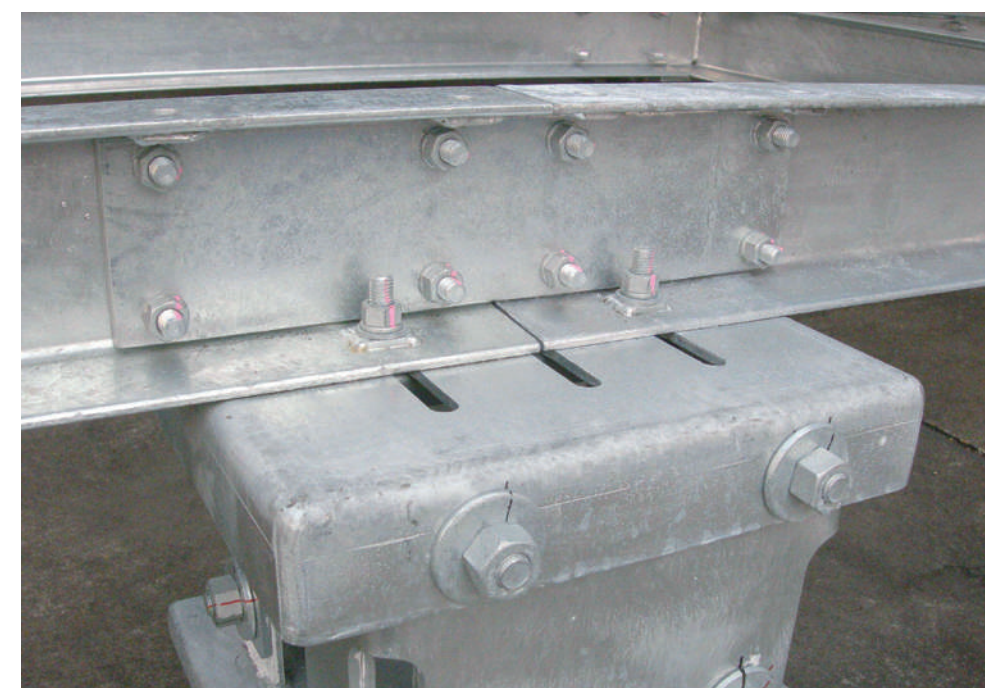
ベルベースA/外アンカーの上部に設備架台を取付け、設備を設置。(H鋼を頭部へ取付けるボルトは別途)
